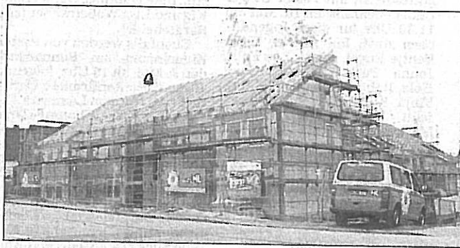
Die Arbeiten gehen zügig voran. Bis Oktober soll alles fertig gestellt sein, dann können die ersten Mieter einziehen. Foto: STRUNK
